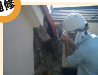
調査で浸入箇所がわかれば、いよいよ補修工事を行います。雨漏りの状況・原因によっては、写真のように壁の内部から補修を施す、本格的な工程を要する場合があります。
