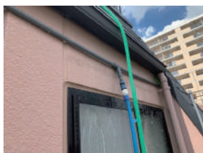
塩ビ管を加工して製作した、「T字」と呼ばれる散水器具。横一列に小さな穴がたくさんあり、水が出ます。壁全体に散水したいときに活用します。
