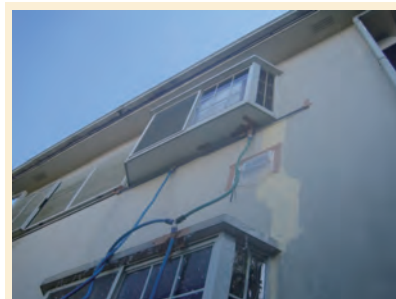
雨漏り診断中の様子。散水器具をセットして水を流し観察し続ける、根気の要る作業となります。
